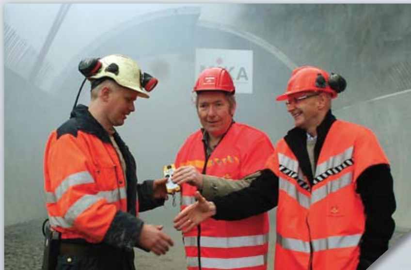
Prosjektchef Stein Fyksen (t.h.) i Statens vegvesen og fylkesordfører Nils Aage Jegstad takker skytebas Jon Magne Hansen for siste salve i tunnelen.
