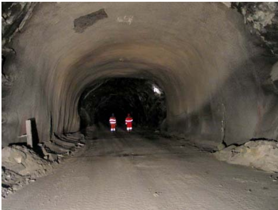
Figur 17 Prøvefeltet etter test. Liten avskalling i hengen.
