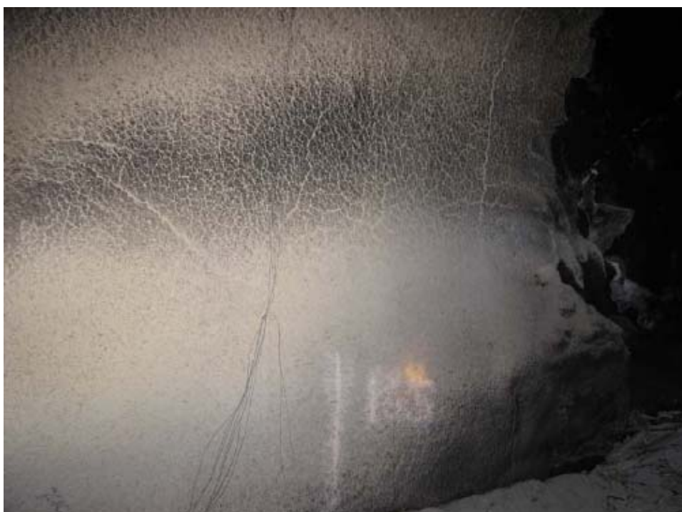
Figur 18 Betydelig oppsprekking av sprøytebetongoverflaten. Sprekkene trenger 2- 3 cm inn. Sprøytebetonghvelvet i dette området var ca. 100 mm tykt.
