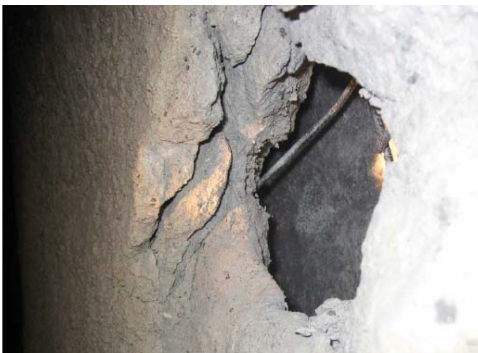
Figur 20 Pigget hull viser armering og intakt isolasjon. Hulrommet i hele prøvekonstruksjonens lengde kunne observeres uten tegn til sot eller annen forbrenning.
