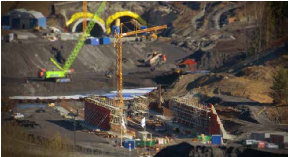
Bildet viser det nye Vøyenkrysset sør for Gran sentrum under bygging. Foto: Rune Midtli
