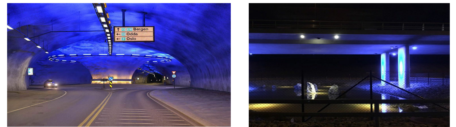
Figur 51. Eksempel på effektbelysning i Hardangertunnelen (t.v.) og effektbelysning ved fordrøyningsbasseng under bru ved Solasplitten (t.h.).
