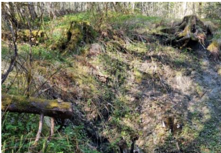
Figur 3-21: Viser erosjon ved området sørvest i skogsarealet ved Tonstad/Sjetnemarka. Dette skyldes trolig at et nedgravd rør har kollapset som videre har ført til at omkringliggende masser ustabile. Foto: Sweco.
