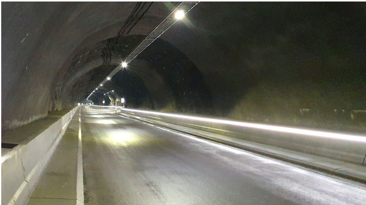
Figur 10: Rv. 5 Kjøsne tunnelen er døme på tunnel der vass- og frostsikring er utført ved hjelp av PE-skum og sprøytebetong ved behov/der det er innlekkasje (foto: Atle Johnny Rygg, Statens vegvesen).
