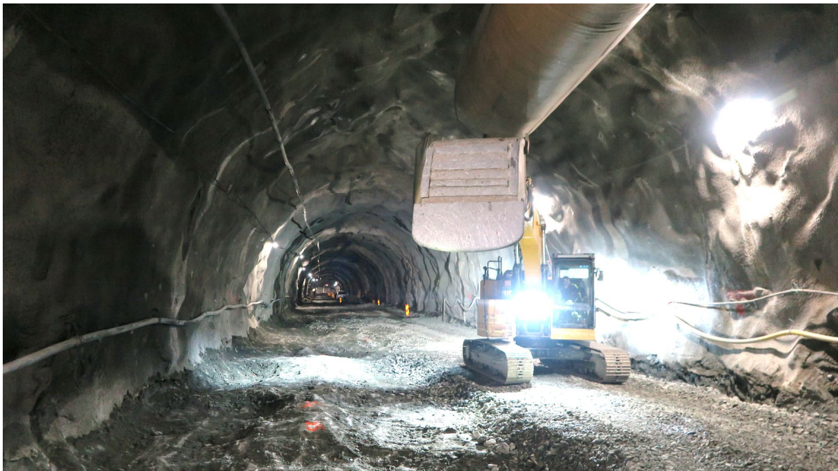
Figur 7: Botnreinsk i Lyshorntunnelen i prosjektet E39 Svevatjørn – Rådal (foto: Statens vegvesen).
