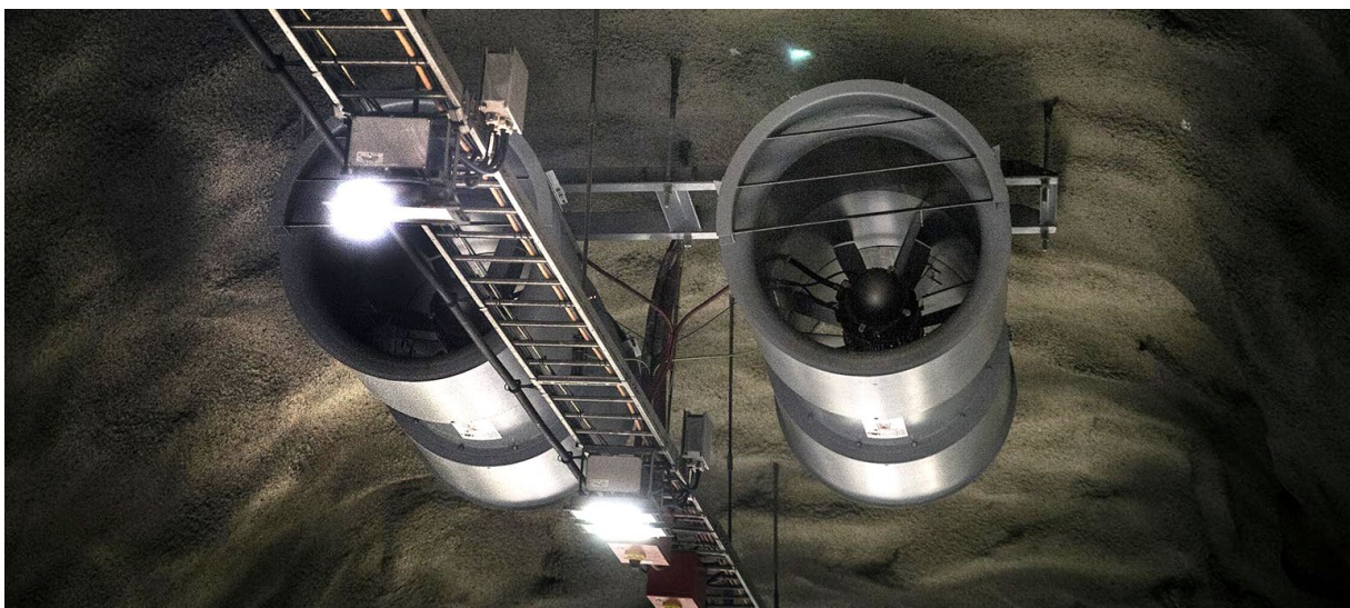
Figur 3: Ventilatorar i E39 Mundalsberg tunnelen (foto: Silje Drevdal / Statens vegvesen).
