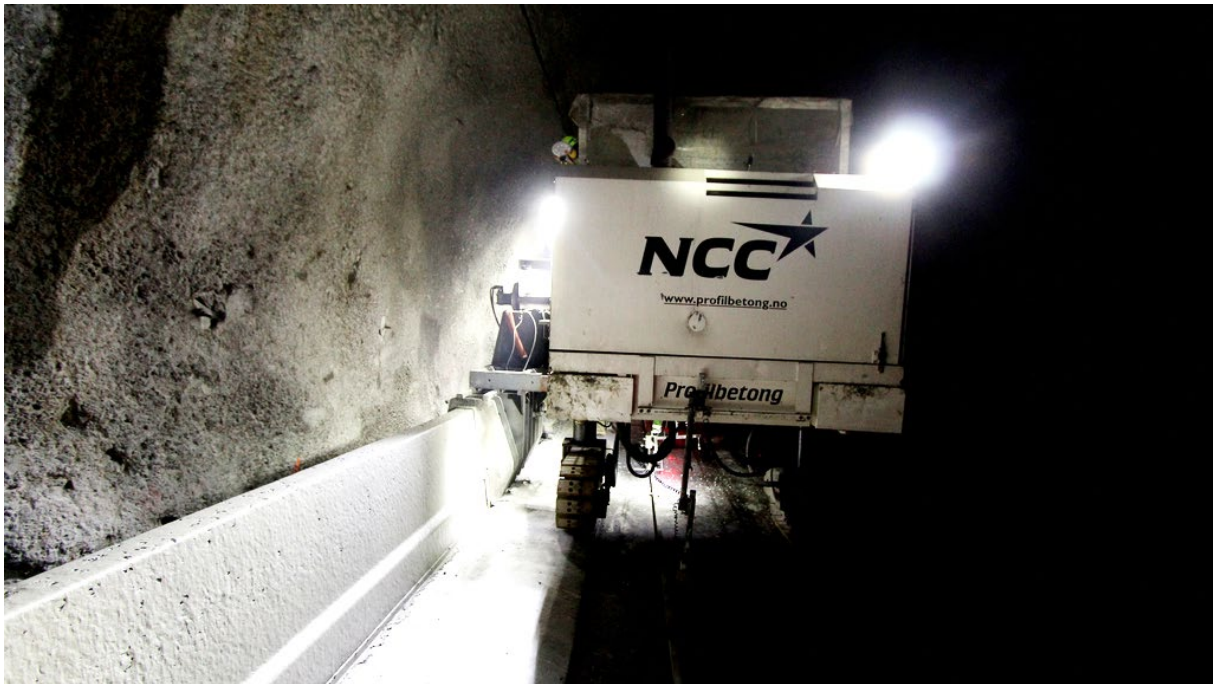
Figur 9: Føringskant er i praksis eit betongrekkverk som vert etablert langs tunnelveggen. Her frå bygginga av E134 Mælefjelltunnelen. (Foto: Tor Arvid A. Gundersen, Statens vegvesen.)
