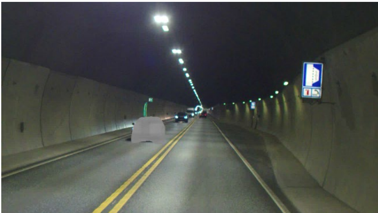
Figur 12: Havarilommer gjer det mogeleg for trafikantar som får problem med køyretøya sine å stoppe utanfor vegbana. Her frå E18 Bambletunnelen. (Foto: Statens vegvesen.)
