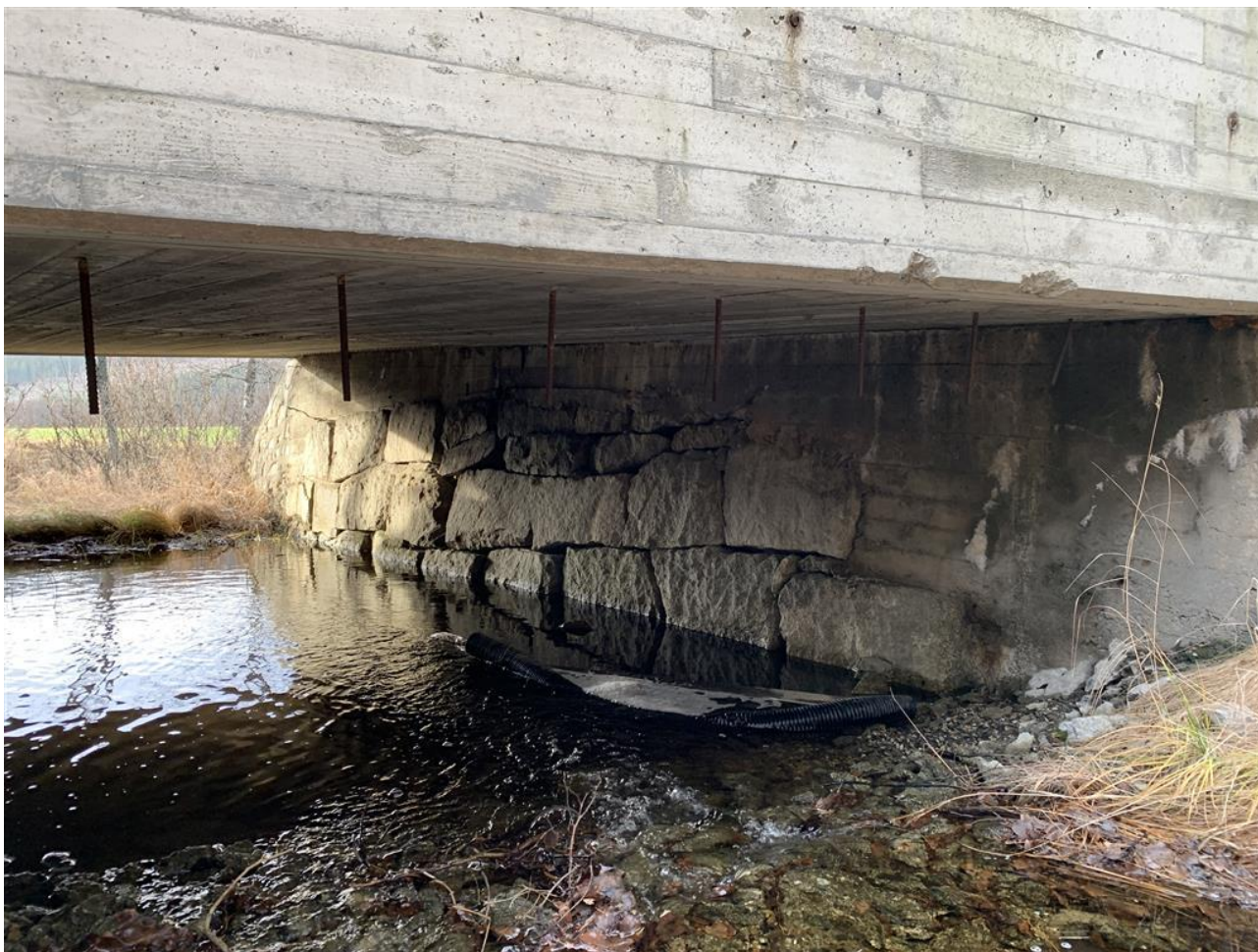
Figur 14. Bilde tatt fra innløpet til Ålrust bru. Det er oppstuvning av vann under brua. Foto: Statens vegvesen.
