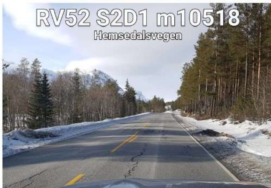
Figur 9 Drift har i 2020 registrert krakelering og teleskader i området. (Kilde: B11993-VEGT-01).
