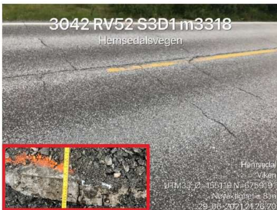
Figur 10 Bilde fra område S3D1 m 3170-3520, hvor det er sprekke dannelse i veg/XPS-platene. (Kilde B11993-VEGT-01).
