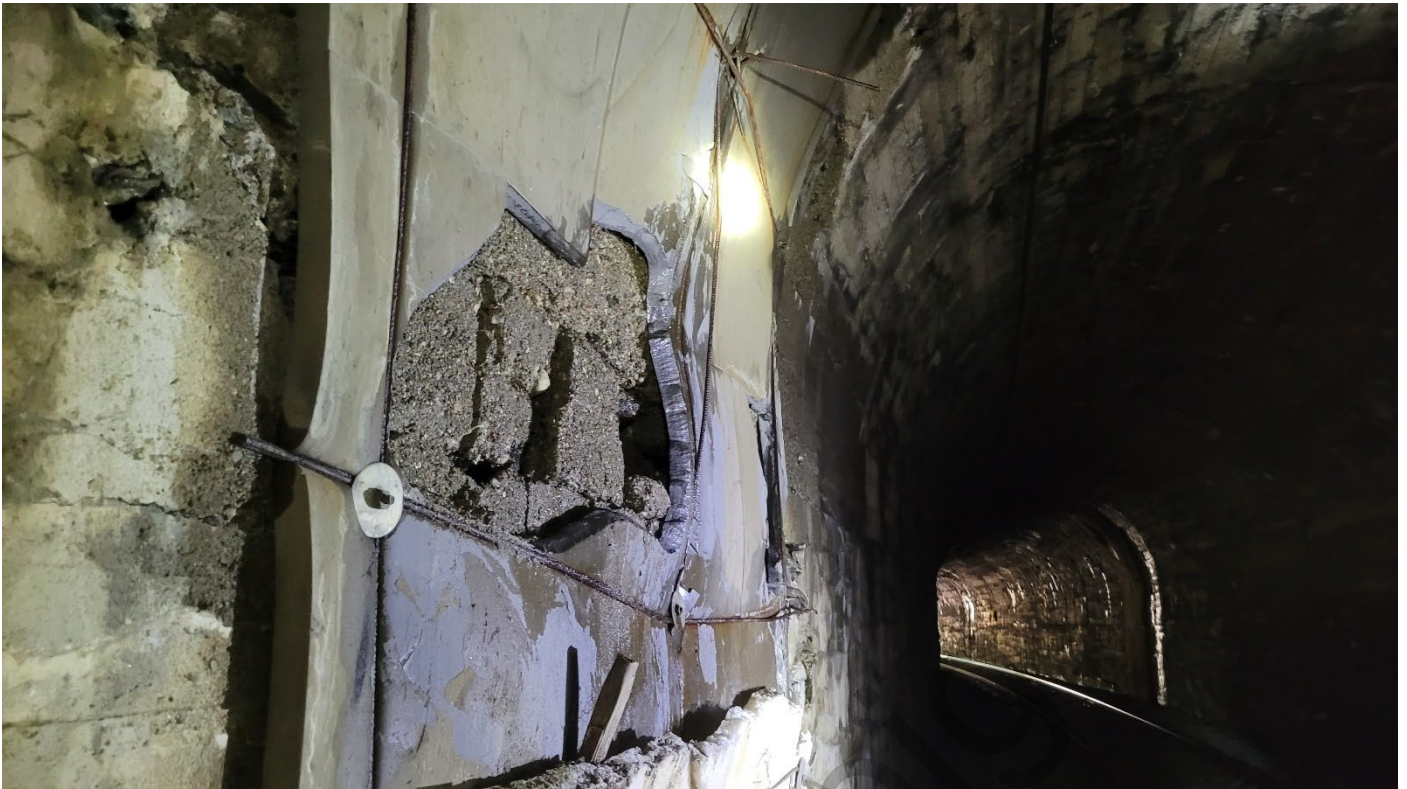
Foto 7: PE-skumfelt venstre side skadet m 279 440. Dårlig tilstand på støp. Fukt.
