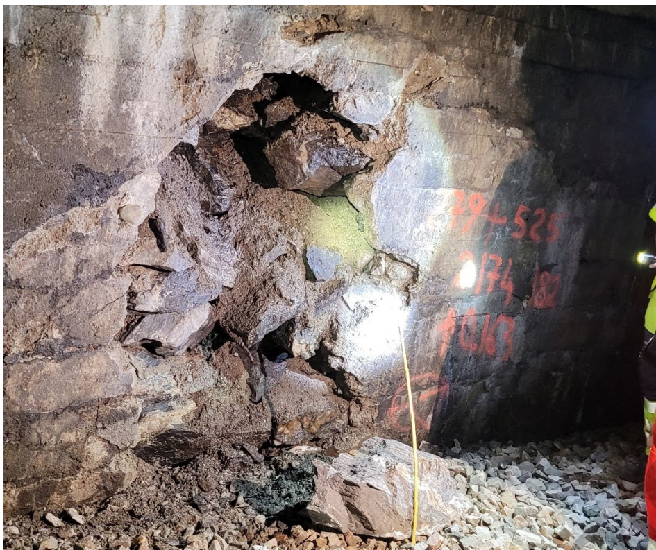
Foto 9: Utfall i venstre vegg/skadet utstøpning ved m 279 525. Ca. 1 m bredt og 1,7 m høyt over sporet.
