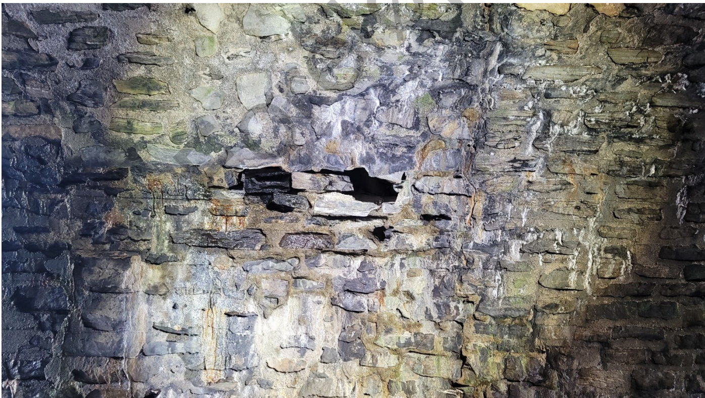
Foto 4: Ca. m 278 443 utfall i støp.
