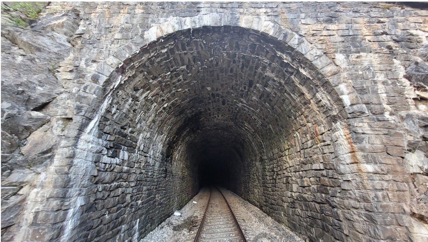
Foto 3: Tunnelinnslaget. Utstøpt i hele profilet fra ca. m 278 428 – 278 453 langs hele profilet og i venstre vegg (vestside) fra ca. m 278 415 – 278 428 i vegg.
