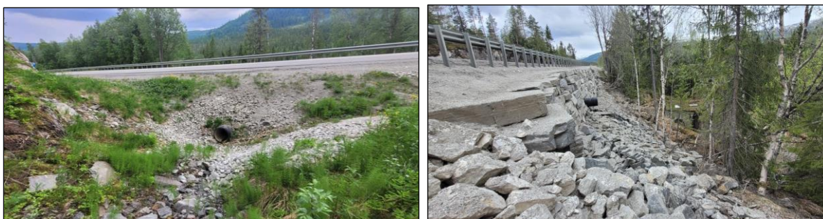
Figur 7 Stikkrenne i mur ved nordre jernbaneåpning, Ø600 mm. Utskiftet i 2020 pga. setninger på E6 ved gammel mur. Bilde til venstre viser oppstrøms E6, og nedstrøms i muren til høyre.
