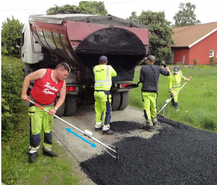
Bilde 2: Ombygd asfaltrake med kraftsensor.
