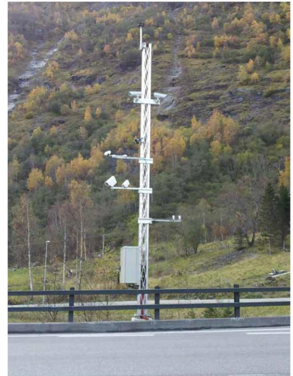
Værstasjon, E16 v/Flåm (fra Hb R613, Statens vegvesen)
