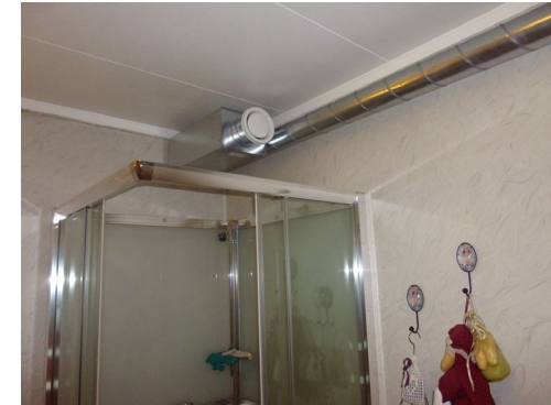
Kanal med utsug fra bad
