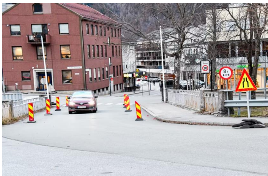
Figur 5 Bildet viser dagens trafikksituasjon på Åndalsnes bru i Rauma kommune. På grunn av alvorlige rustskader er kjørebanelen snevret inn for å opprettholde dagens bruksklasse T8/40. Ny bru er under planlegging. Foto: Åndalsnes avis.
