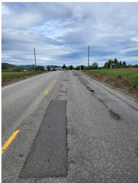
Foto: Skader i asfaltdekke
