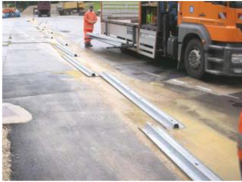
4.3 Auslegen von SP-Holmen als Schiene für die Ramme Placing the beams for the piling frame
