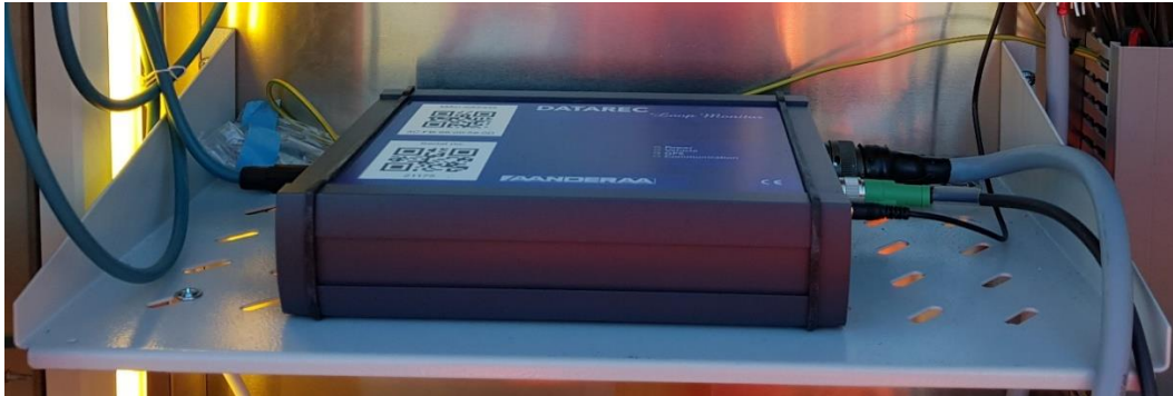
Figur 2. Eksempel på en Loop Monitor sykkel plassert på hylle i skap.
