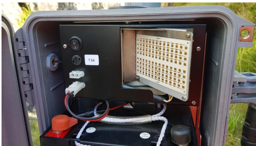
Figur 11. Kobling av batteri til datalogger.
