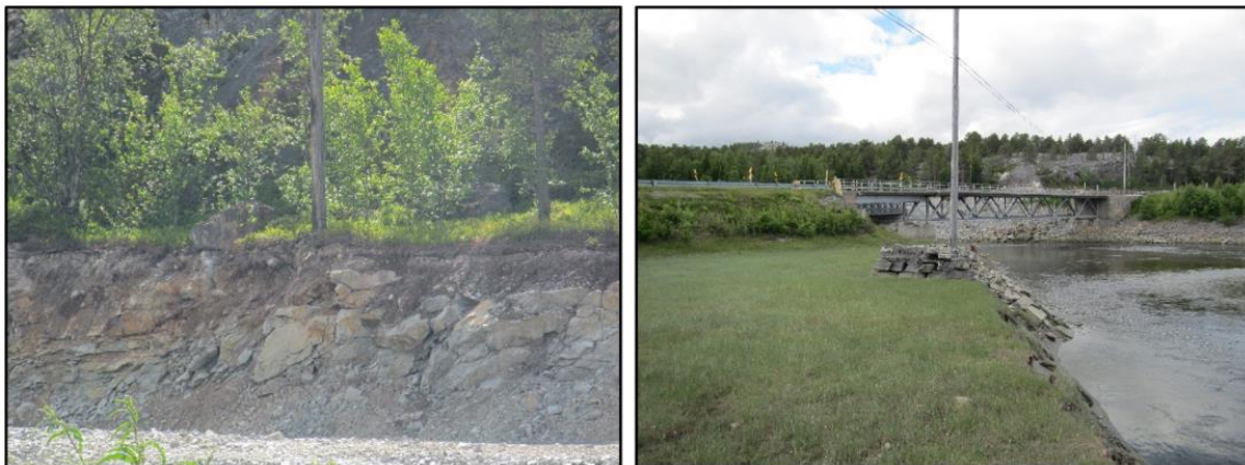
Figur 48: Stolper med skadet fundament. Bildet til venstre viser stolpe i skråning. Bildet til høyre viser stolpefundament som har rast ut i elva. Foto: Statens vegvesen.
