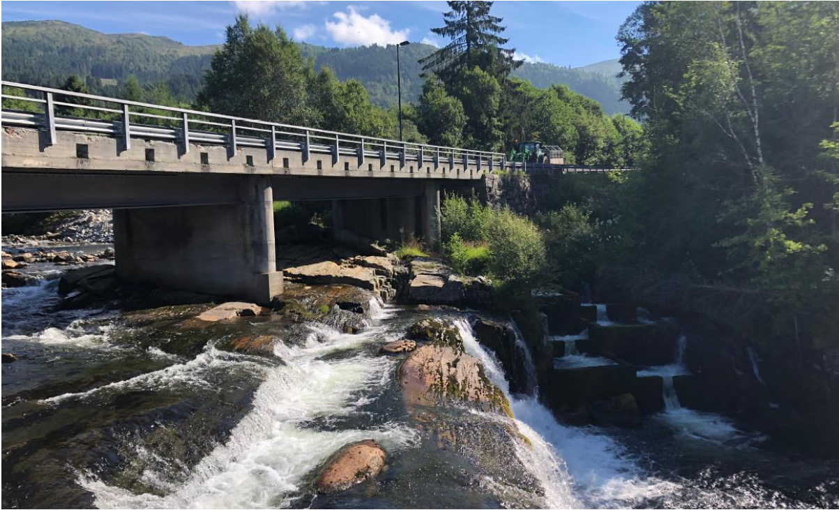
Figur 18: Foto som viser fundamentering av dagens bru. Alle fundament er direkte på berg. Laksetrapp til høyre
