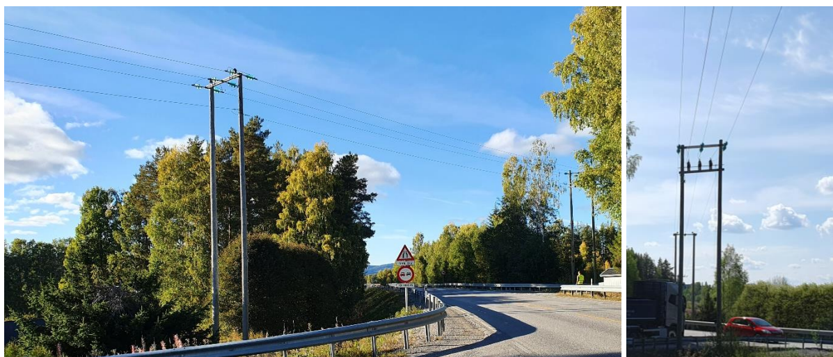
Figur 9: Foto av 22 kV høyspentlinja som krysser rv. 2 i planområdet.
