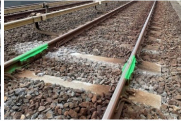
Skader isolerte skjøter, Furusetbanen
