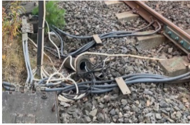
Dårlig kabelforbindelse, Grorudbanen
