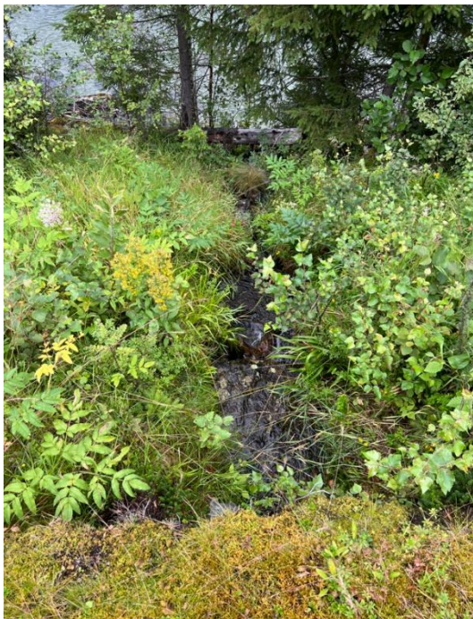
Figur 4.1. Bildet viser sårbarhet for gjentetting av vegetasjon i kulverter ved analysefelt 2 - Slokerabben.
