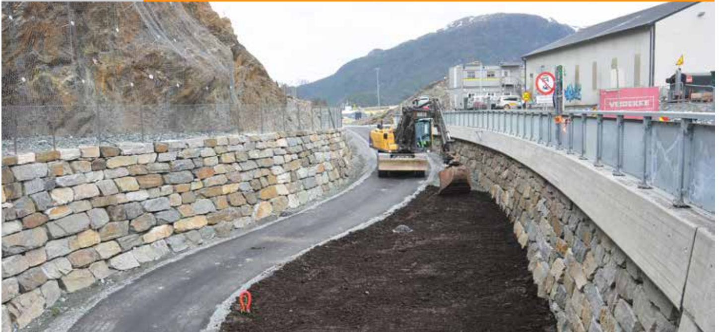
Fv. 160 Ulvenvegen får god gang- og sykkelveg. Her er sluttarbeid ved undergangen i sørenden.
