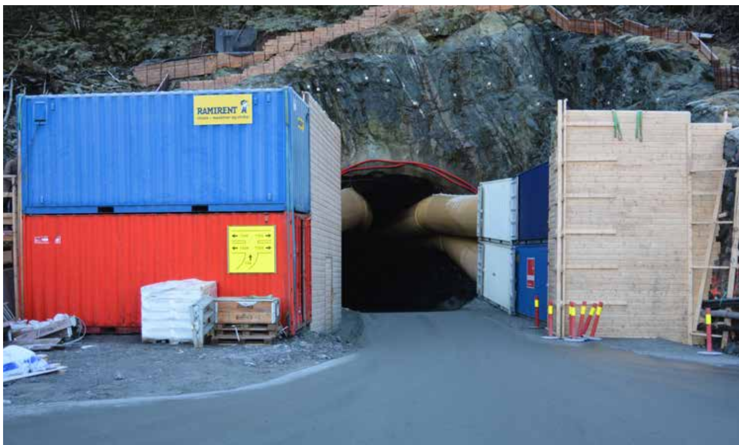
Ventilasjonsviftene ved tverrslagstunnelen på Hamre er bygget inn i hus for å redusere støyen.
