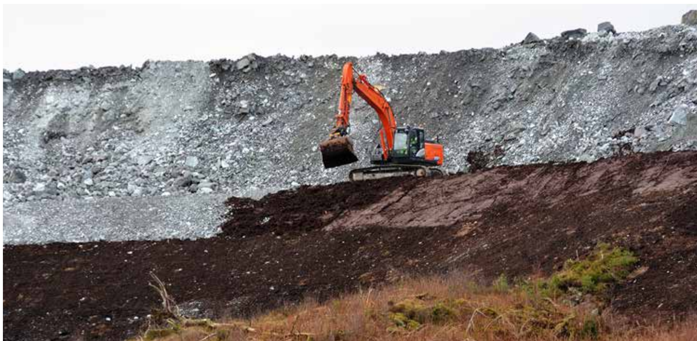
Gravmaskin legger jord på skrånningen til deponiet i januar 2018, sett fra Stavollen.
