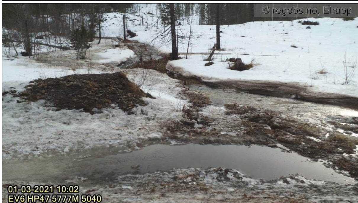
Figur 2: Bilder av tidligere hendelser på sørpeskredhendelser på veg. Bildene er tatt 3 dager etter registrerte skredhendelser. Topp: sørpeskred ved m6400-6550 langs bekkeløp, skredmassene havnet i grøft og vegbane. Bunn: Sørpeskred ved 5700-5800 langs bekkeløp, skredmassene havnet i grøft, men førte til overvann på veg.
