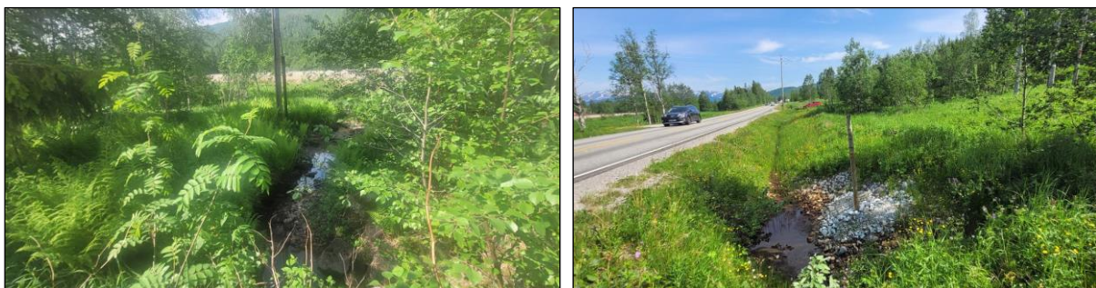
Figur 9 Bekk rett sør for Fredvang som samles i fellesbekk med utløp i Namsen. Stikkrenne Ø600 mm i vest, men Ø300 i øst betyr at stikkrenne er skjettet på. Mulig fiskeførende.
