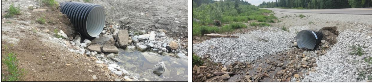
Figur 21 Nye stikkrenne sør for Russerleiren. Ø800 mm. Ved ny E6 vil dagens veg fjernes her. Oppstrøms til venstre uten terskel. Nedstrøms er det benytte betongrester/-steiner som trapping. Dette bør fjernes, og erstattes av naturstein, og bør ikke vente på ny E6. Utført 7. september 2023.
