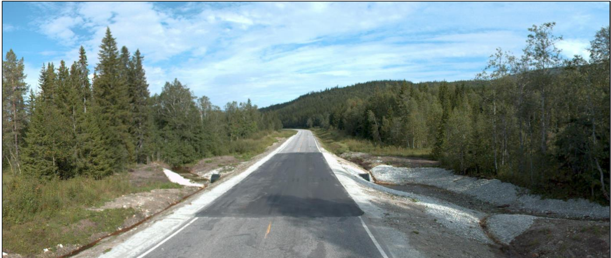
Figur 31 Stikkrenne er skiftet i 2020–22. Området i nord mot sving på E6 er utsatt for sørpeskred.
