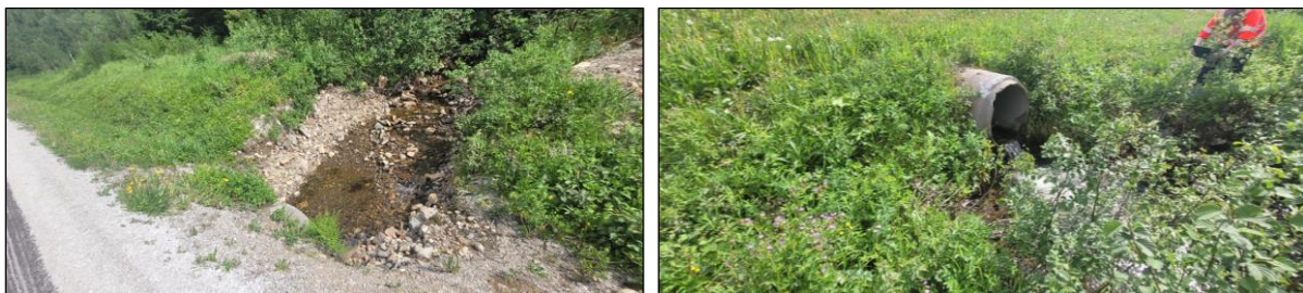
Figur 37 Bekk nord ved Russerleiren, sør for driftsavkjørsel. Fint bunnsubstrat i bekken oppstrøms. Terskel i nedstrøms ved bekk sør for driftsavkjørsel. Betongrør Ø800 mm.
