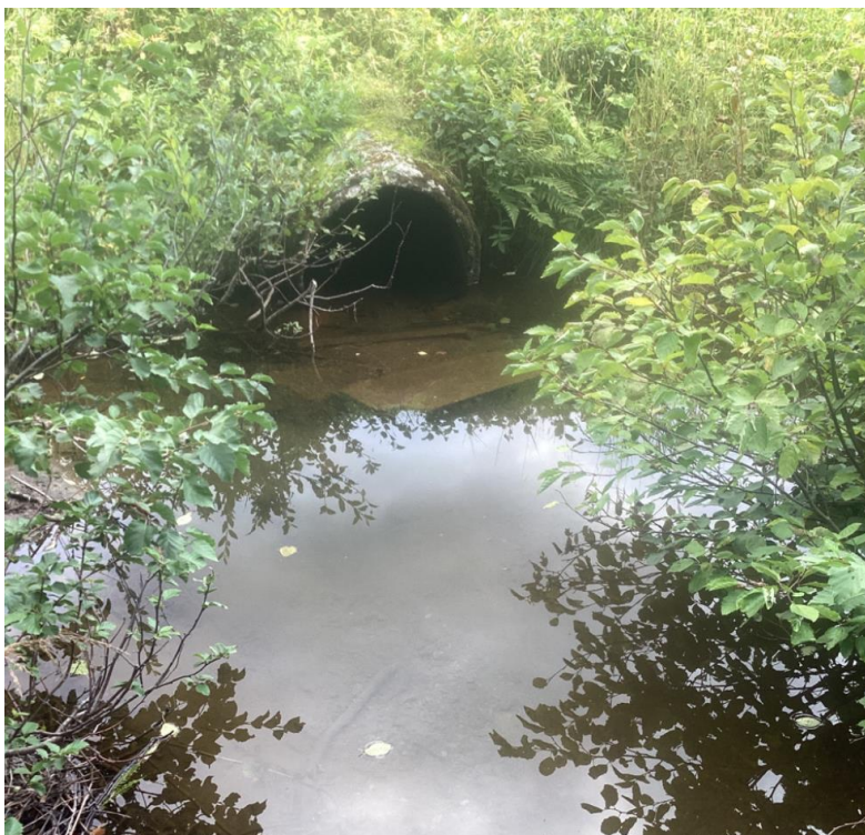
Figur 8 Stikkrenne under E6 godt utformet for fiskevandring.
