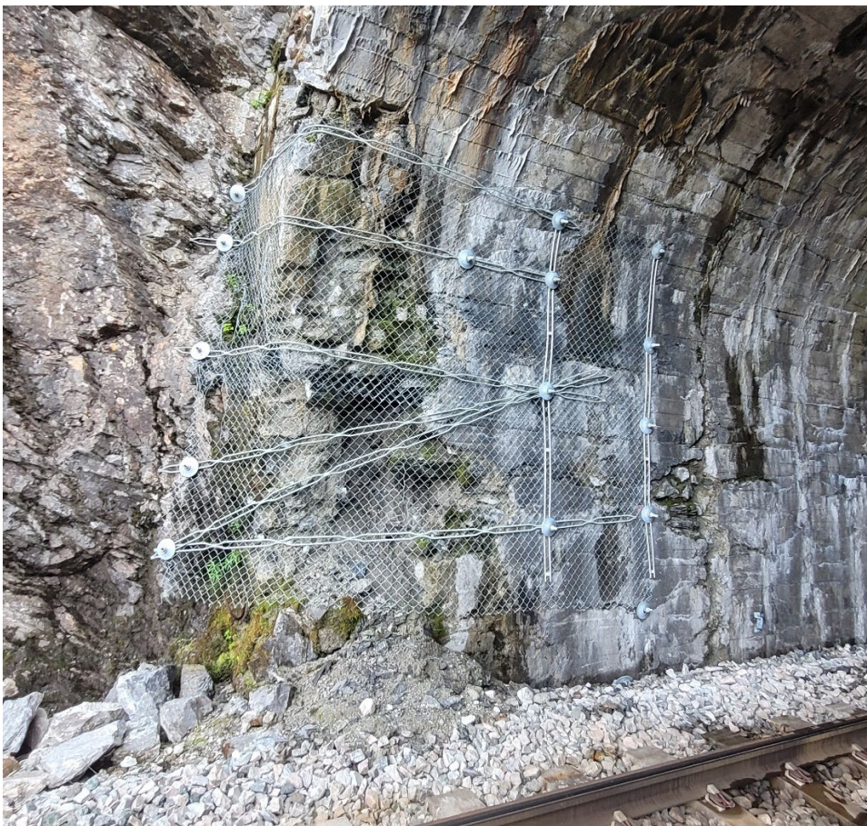
Foto 10: Utstøpning nordre påhugg i dårlig forfatning. Stabilisert med flettverksnett, fjellbånd og bolter.
