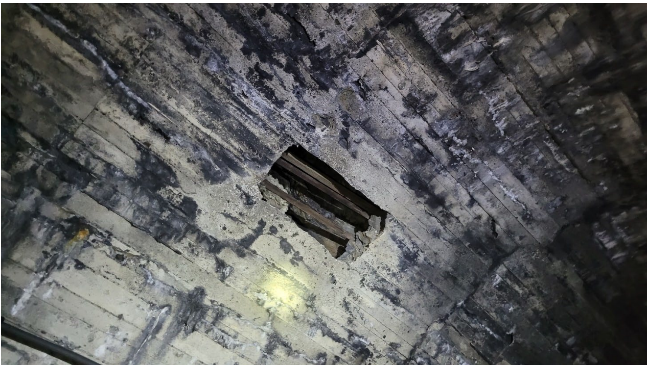
Foto 8: Utfall i utstøpning m 279 442. Ca. 1 x 0,5 m har falt ut.
