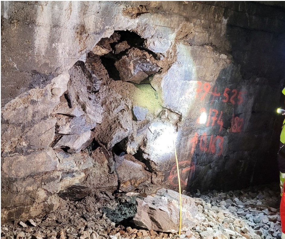
Foto 9: Utfall i venstre vegg/skadet utstøpning ved m 279 525. Ca. 1 m bredt og 1,7 m høyt over sporet.
