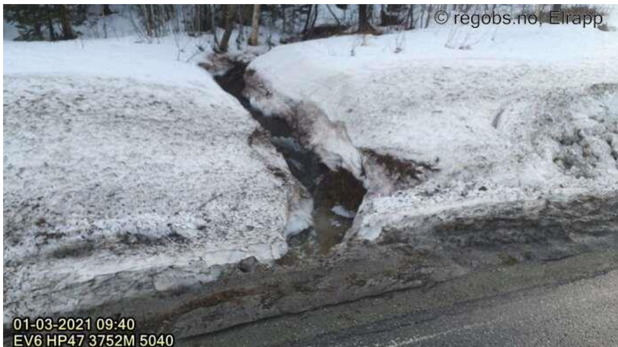
Figur 2: Sørpeskred langs bekkeløp på veg ved pr. 3750. Skredhendelsen førte til vann og sørpemasser på vegbanen. Skredet skyldes værromslag midtvinters. Bildet er tatt 4 dager etter skredhendelsen.
