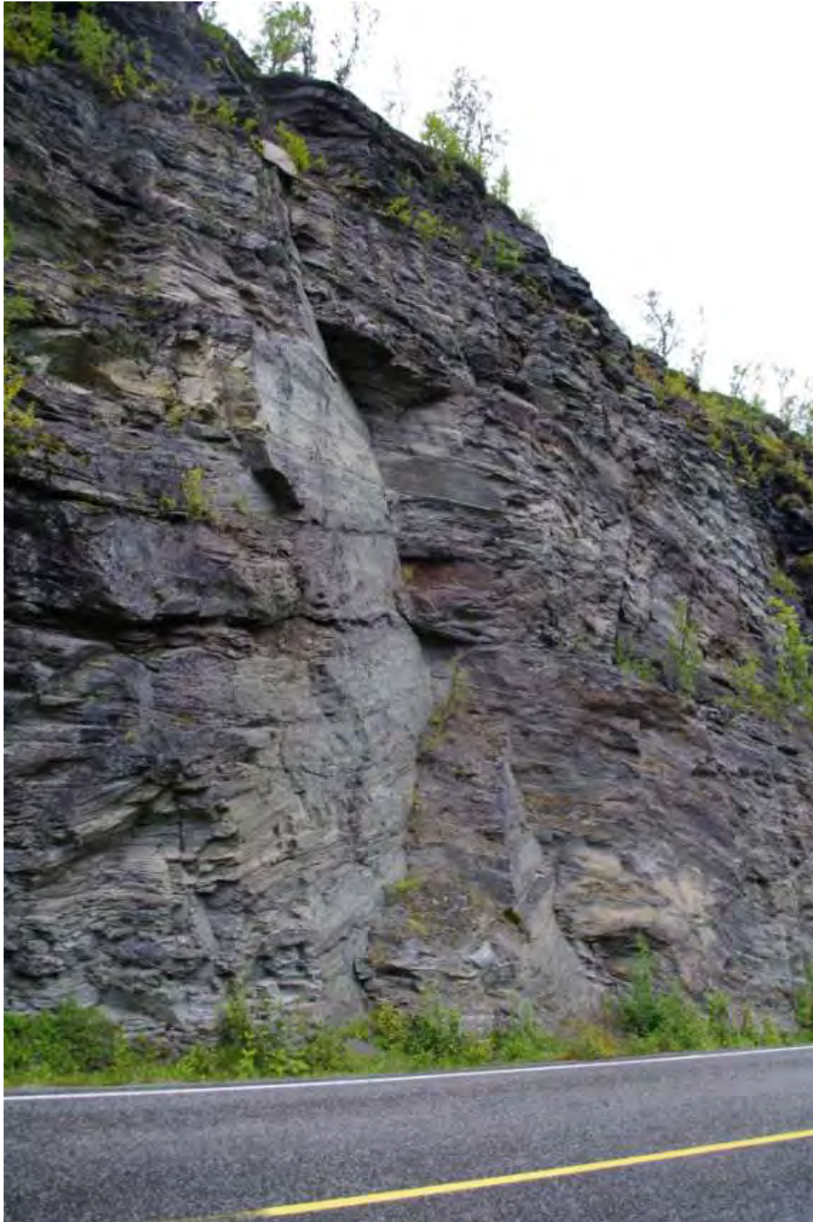
Bilde 22 Start av høy skjæring ved p. 3680 (GPS 325). En del åpne foliasjonssprekker med sprekkemateriale.
