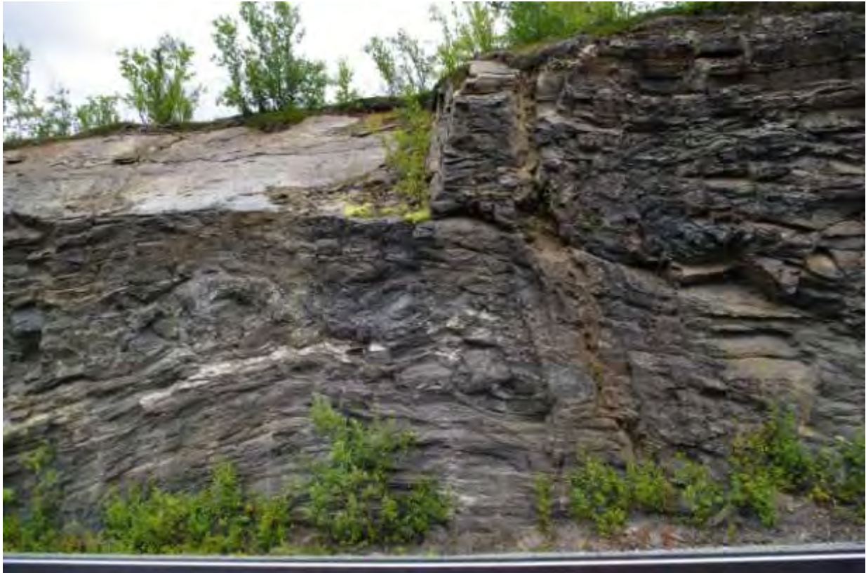
Bilde 24 Utfall langs foliasjonsplan og vertikalt sprekkesett vinkelrett på skjæring ved p. 3895 (GPS 327).
