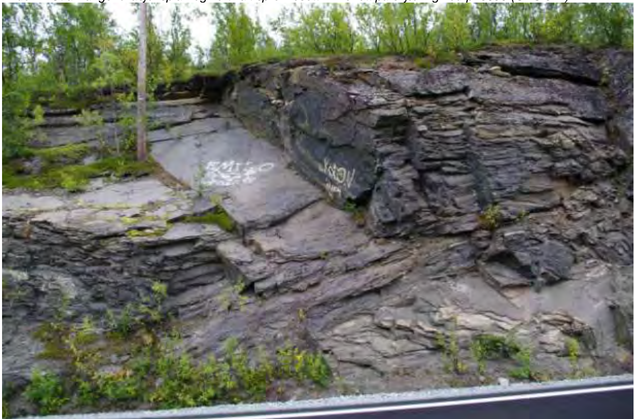
Bilde 25 Utfall langs foliasjonsplan og vertikalt sprekkesett vinkelrett på skjæring ved p. 3960 (GPS 328).
