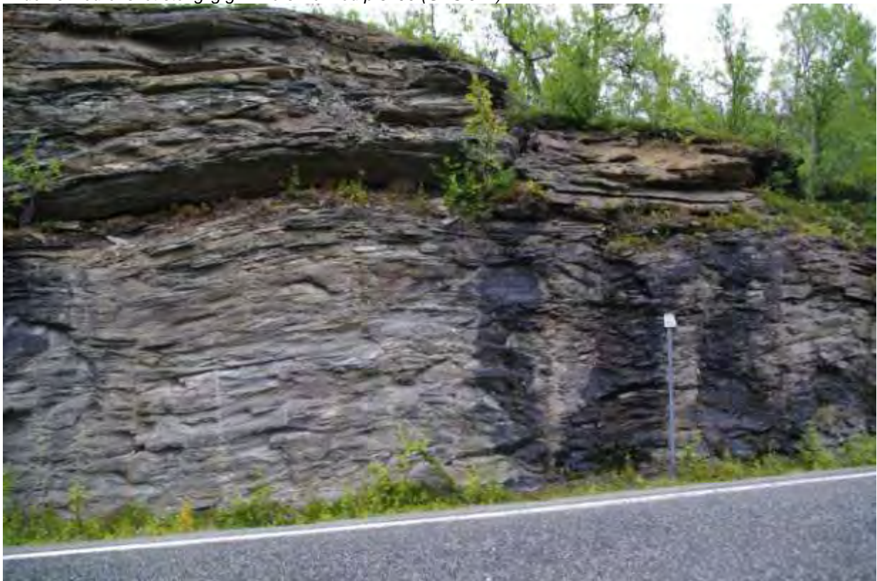
Bilde 20 Ca 6m høy ved p.3560 (km 23). Skjæringen er delt av en 2dm bred sone med svært forvitret fjell. Over denne sonen er fjellet forvitret og åpent i foliasjonssprekkene. Under sonen er fjellet mer solidt.
