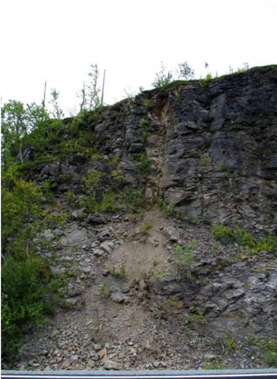
Bilde 27 Forvitret småfallent fjell i start av skjæring ved 4120 (GPS 329)
