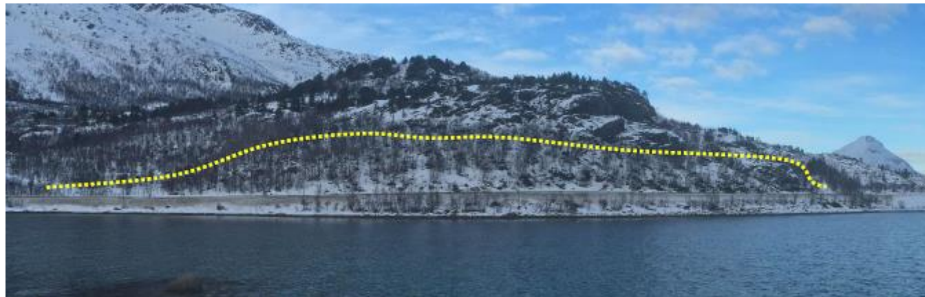
Figur 25: Foto av prosjektert bergskjæringstopp til Bergskjæring 2 i Djupfest, her sett mot nordvest. Stiplet gult angir ca. plassering av bergskjæringskant. Foto: Finn Sverre Karlsen.
