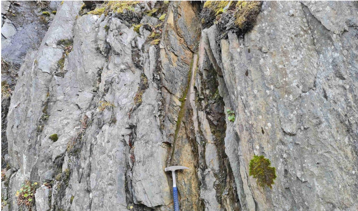
Figur 28: Den eneste myke fyllittsekvensen på ca. 30 cm tykkelse (vises vertikalt, ved hammeren), som viste sulfidmineralforvitring med mulig syredannelsespotensiale. Ca. ved profilmeter 3140
