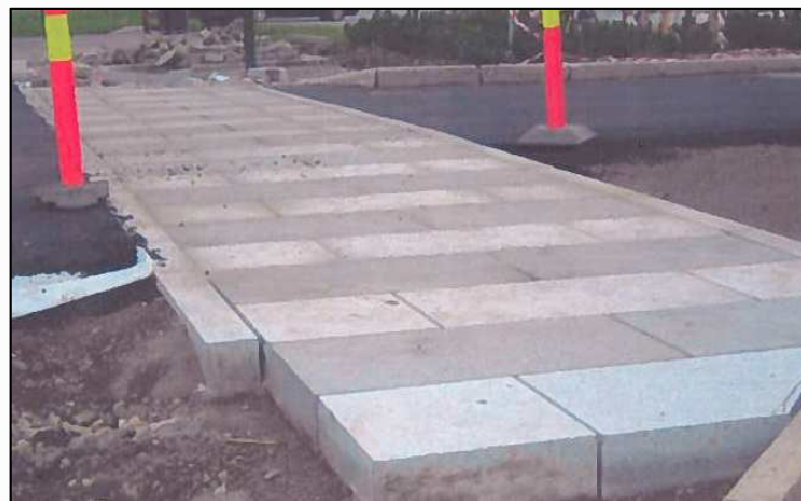
Eksempel på hvordan enkelte fotgjengeroverganger i miljøgata kan fremheves spesielt med rektangulære granitheller
