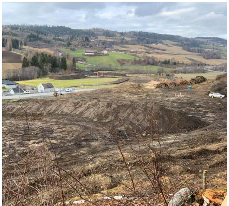
Med kuldegrader og tele i jorda kan Hæhre/Isachsen starte arbeidet med å flytte matjorda som er lagt til side i traseen for ny motorveg på Hadeland. Foto: Stein Bruno Larsen/Statens vegvesen
