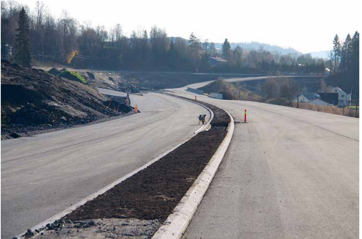
Her blir det innkjøring til den kommende Granstunnelen fra nord. Foto: Frank Andersen
