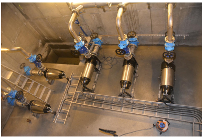
Pumpestasjon i Tunnel. Foto Tore Paulsen
