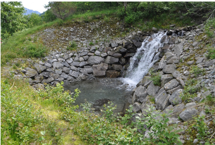
Figur 7: Sikring for sørpeskred/flomskred. Foto: Marie Drågen
