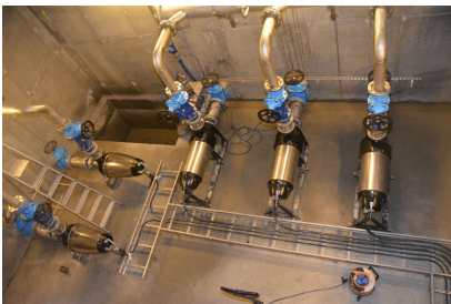
Pumpestasjon i Tunnel. Foto Tore Paulsen
