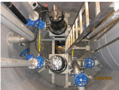
Pumpestasjon i kum. Foto: Terje Rønneberg
