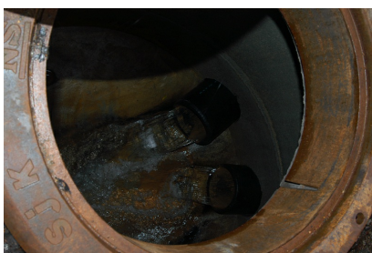
Kum i tunnel. Foto: Kjell Wold
