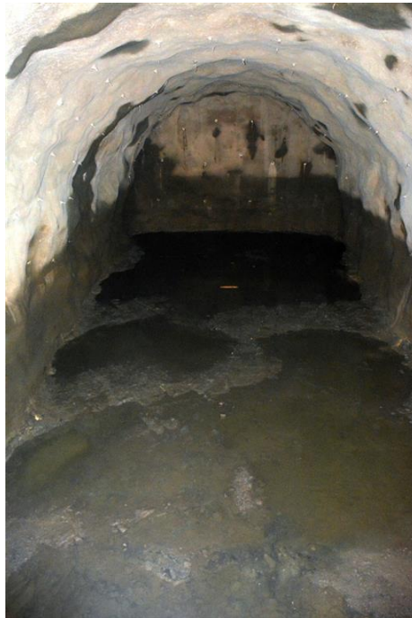
Pumpesump: Foto: Tore Paulsen
