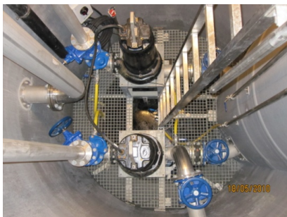
Pumpe stasjon i kum. Foto: Terje Rønneberg
