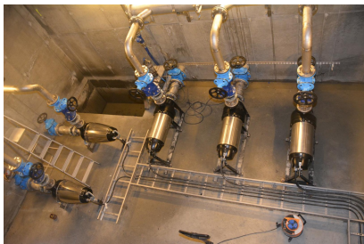
Pumpe stasjon i Tunnel. Foto Tore Paulsen
