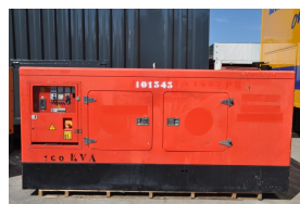
Stasjonært strømaggregat. Foto: Bredenoord
