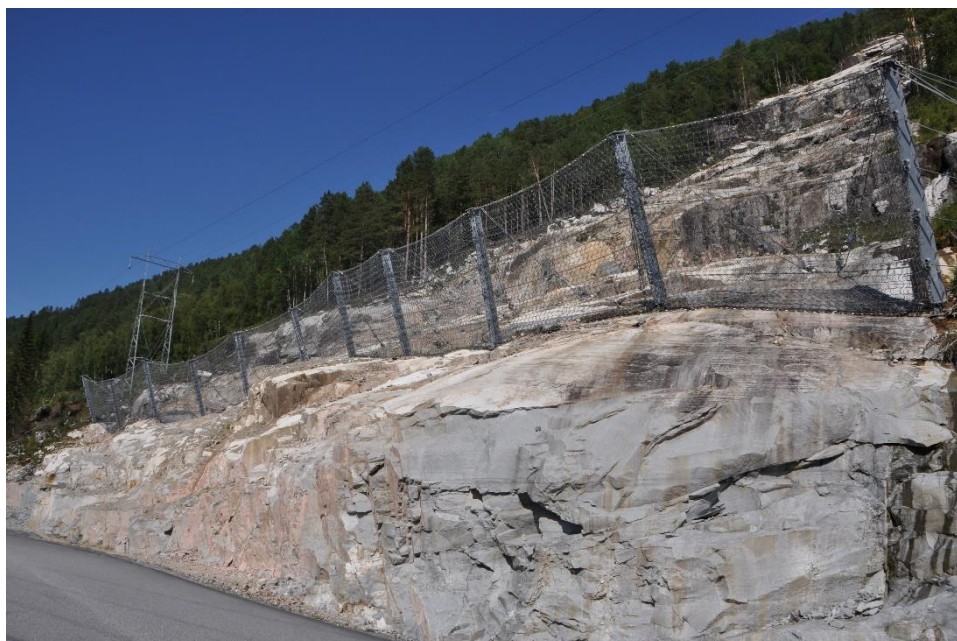
Figur 1 Fanggjerde (Foto: Halgeir Dahle / Statens vegvesen)
