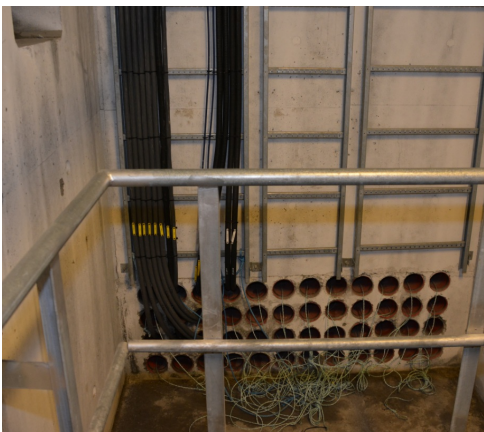
Trekkerør inn til hovedfordeling. Foto: Tore Paulsen
