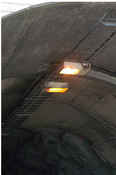
Lysarmaturer i Tunnel. Foto Kjell Wold
