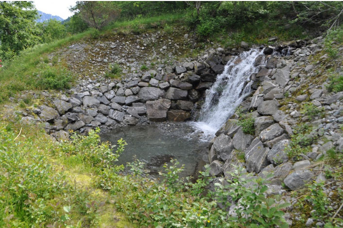
Figur 7: Sikring for sørpeskred/flomskred. Foto: Marie Drågen
