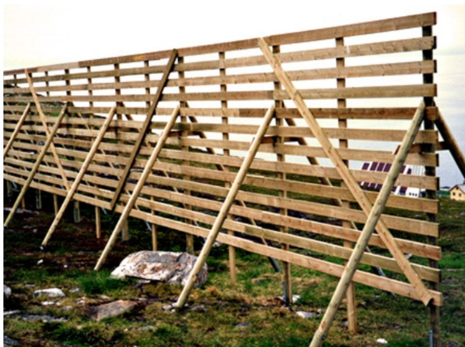
Figur 1 Snøskjerm (Foto: Statens vegvesen)
